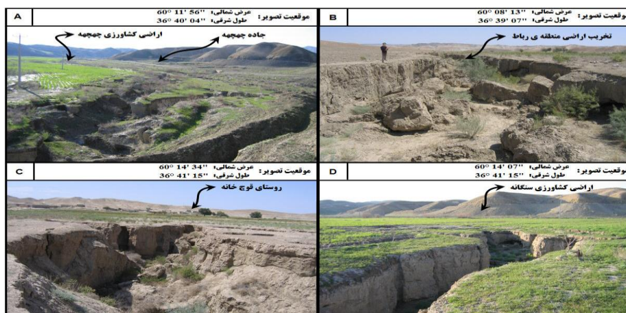
شکل ۲: تصاویری از آبکندهایی که در منطقه مورد مطالعه رخ داده است؛ آبکندها برای زیرساخت‌های انسانی (آنتروپوژنیک) مانند جادها و ساختمان‌ها (A-C) و زمین‌های کشاورزی (D) خطرناک هستند.
